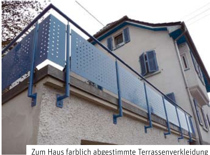
Zum Haus farblich abgestimmte Terrassenverkleidung
