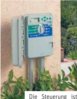
Die Steuerung ist bequem per Fernbedienung möglich. Steuergeräte passen automatisch die Wassermenge an die Wetterlage an. (Foto: djd/www.rainpro.de)
