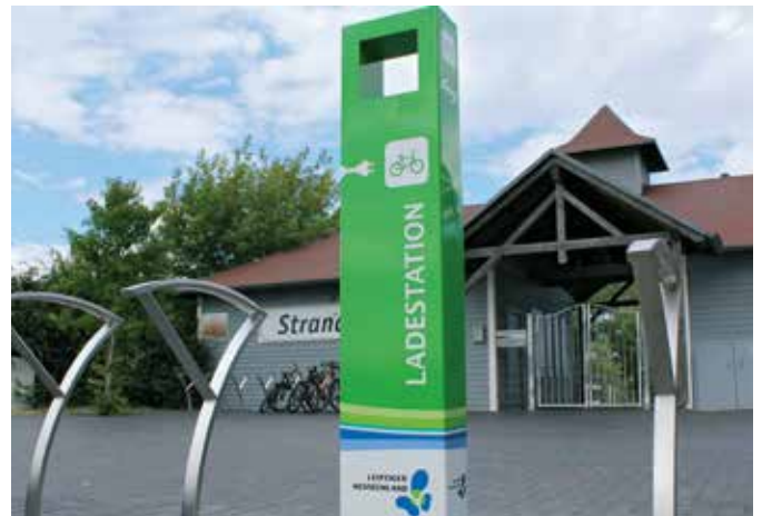
Neue Ladesäule für E-Bikes am Strandbad
